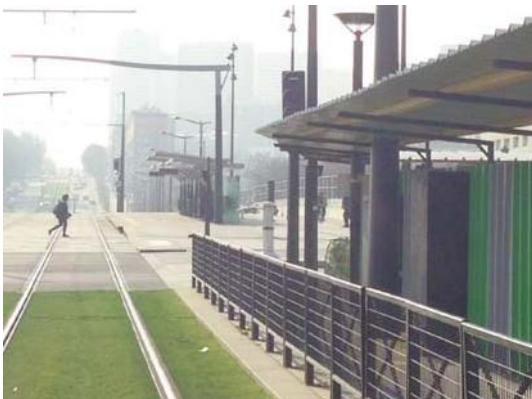
工地防护设施遮蔽其他用户和信号装置
