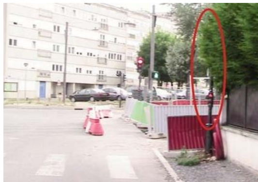
路基施工期间发现的遮蔽：沿街树篱遮蔽交通灯
